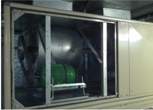
FIGURA 6.3: Foto do motor substituído / Especificação técnica
